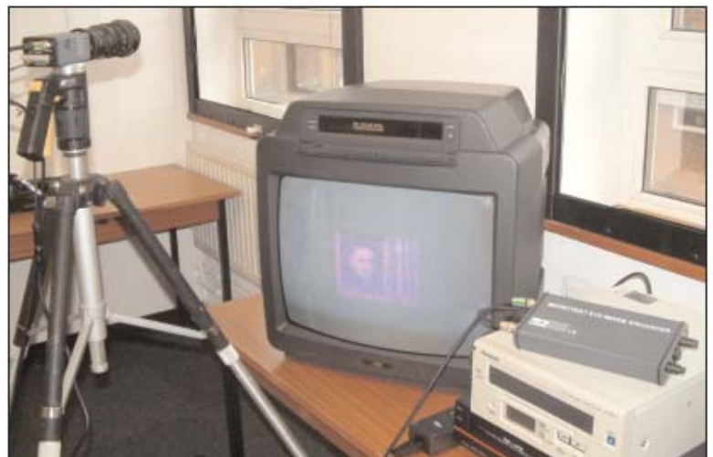
Installation typique avec une caméra CCTV, un moniteur et VCR
